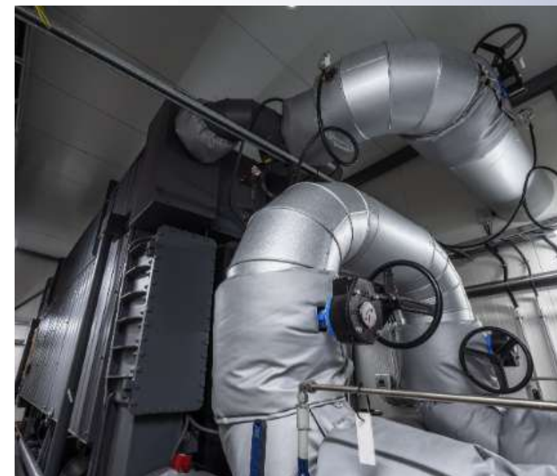
5 MW siltumsūkņa uzstādīšana SC Ziepniekkalns, kas, nepatērējot papildus kurināmo, ļauj iegūt papildus siltumenerģiju
